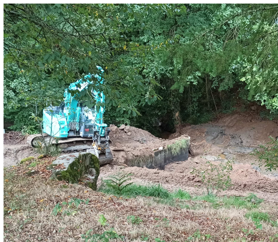
Destruction de la digue du plan d'eau
